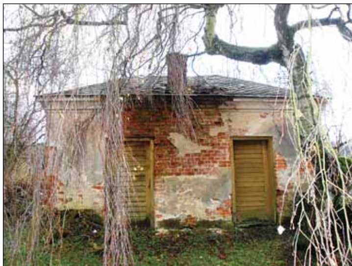
Márnice v Třemešku před opravou
